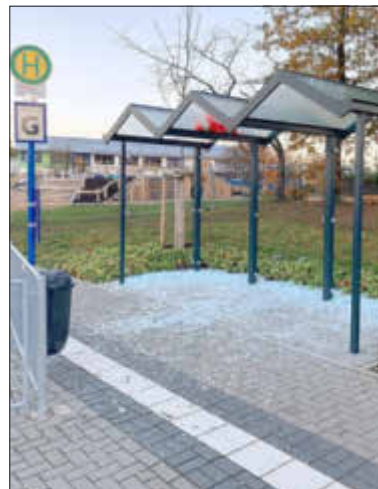
Zerstörte Glasscheiben an der Buswartehalle am Schulzentrum Horhausen
