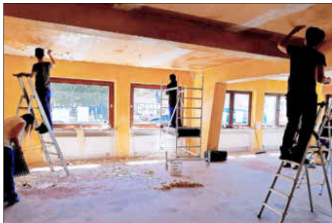
In Weyerbusch nutzten die Neue-Arbeit-Teilnehmer die Corona-Sommer-Monate, um den Gesellschaftsraum im „Gasthof zur Post“ im Auftrag des „Brodvereins“ auf Vordermann zu bringen. Foto: Neue Arbeit
